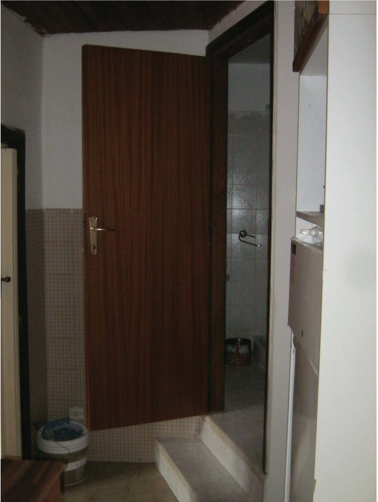
FOTOGRAFIA N.8: ingresso al servizio igienico abusivo
